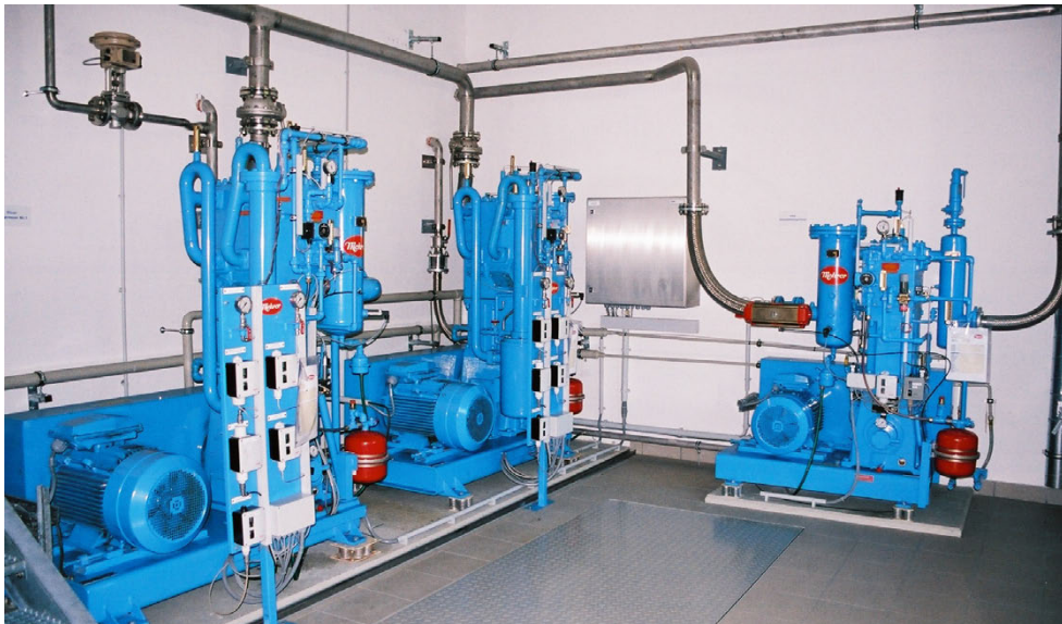
CO 2 -Kompressoren in der Verdichterstation
